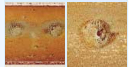
Lochfraß in einem mit Rost bedeckten Kupferrohr – 15 x 1 mm
